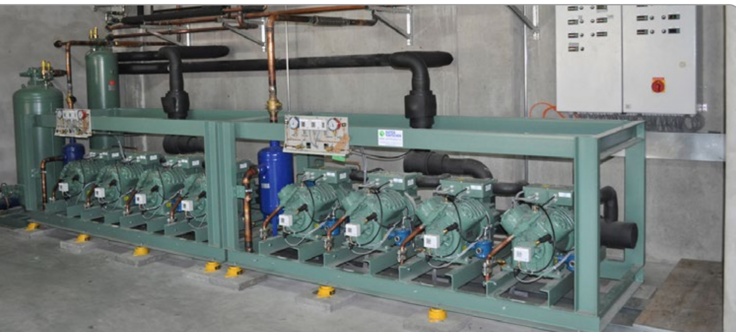
Beispiel für eine Kälte-Verbundanlage
